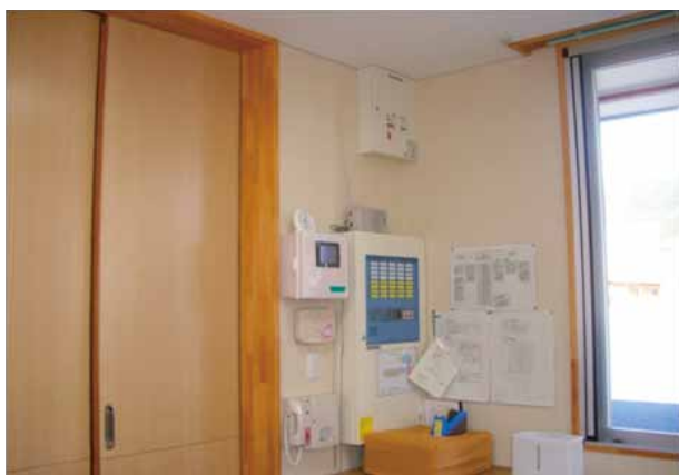
写真4 デマンドコントローラー
