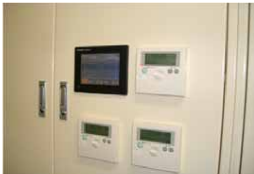
写真2 デマンドコントローラー表示装置
