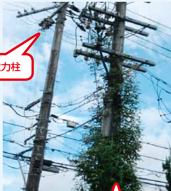
構内第1柱高圧交流負荷開閉器（お客さま資産）既に避雷器まで伸びたつる草
