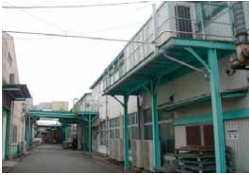
写真1 空調機器設置状況
