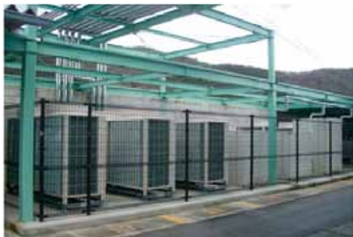
写真3 空調機器設置状況
