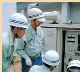
非常用発電機点検実習
