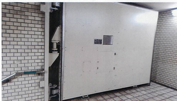
（阿波座駅に設置してあった止水鉄扉）
