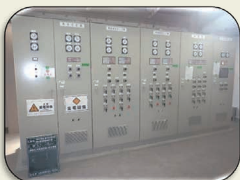
第1排水機場制御盤
