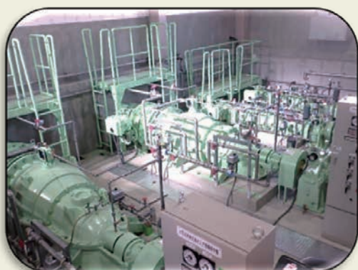
第1排水機場ポンプ
