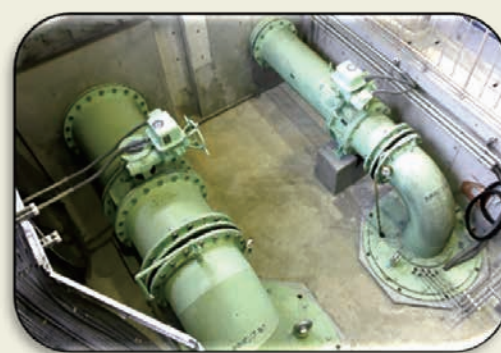
第2排水機場ポンプ
