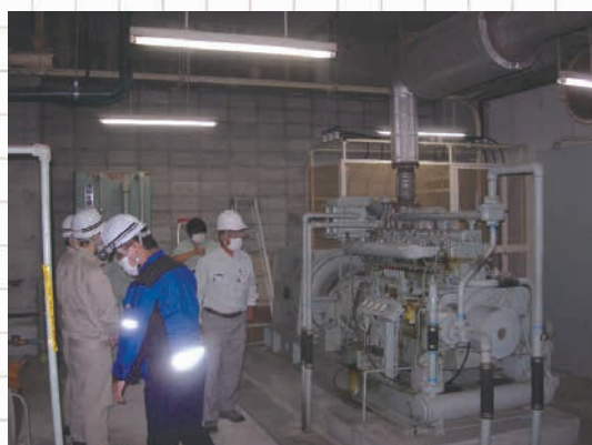
非常用発電機の点検
