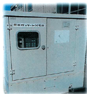
非常用予備発電機
