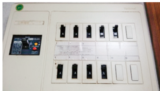
（写真1：送り先の表示がない分電盤）
