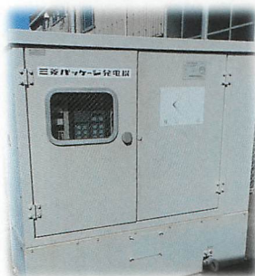
非常用予備発電機
